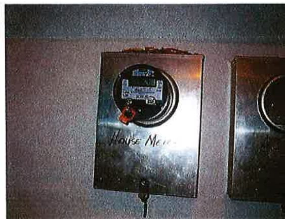
House FPL Meter
