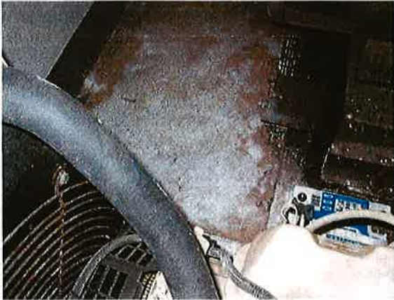
Debris on Floor next to Em Gen
