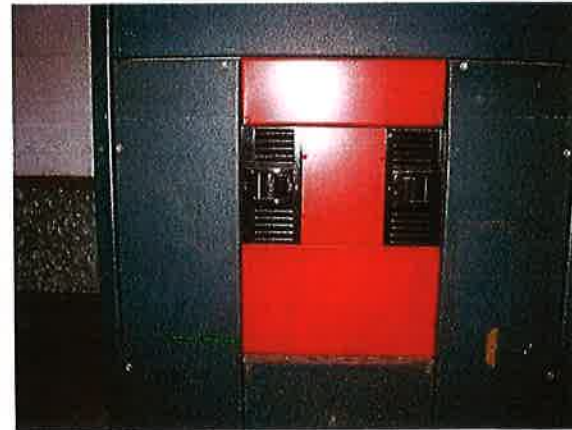
Main Switch Board EM CBS
